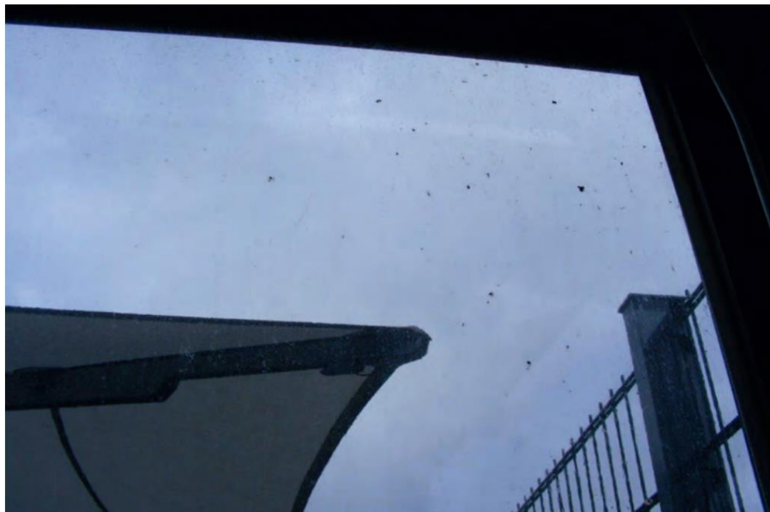
Bild 9.4.5 På PVC-fönstret kan det uppstå repor och längsgående ränder
